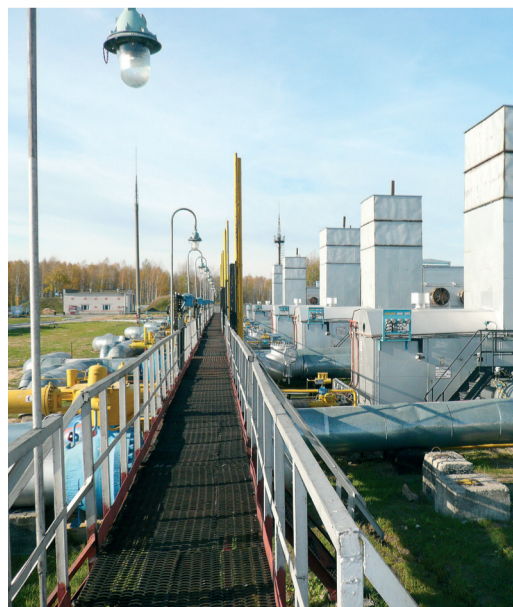
Площадка ГПА КС Муромская
