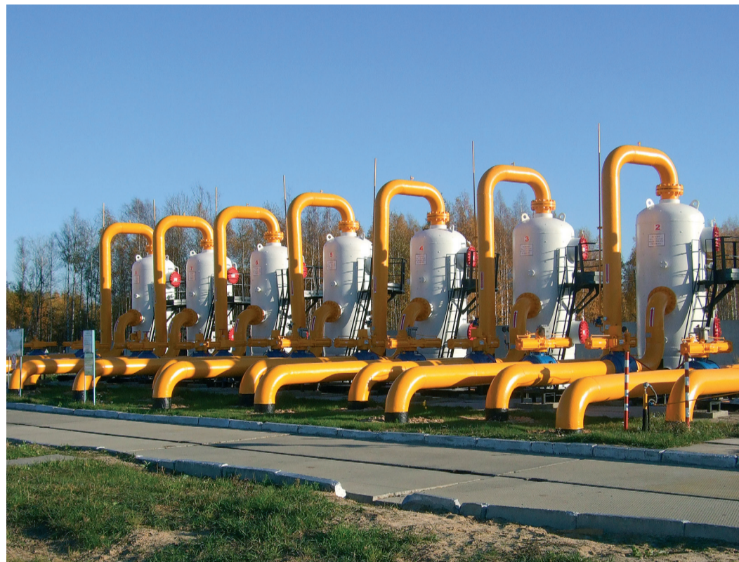
Площадка пылеуловителей КС Муромская
