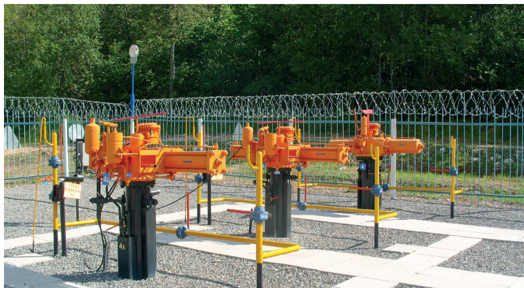
Площадка ПЗРГ Полянского ЛПУ МГ
