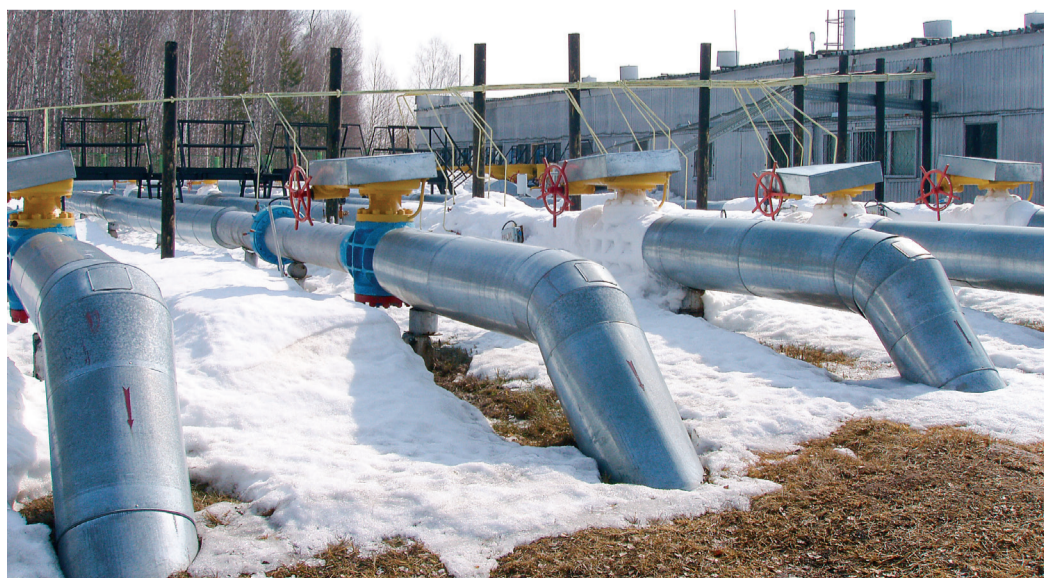
Площадка ГРС-5 г.Казань
